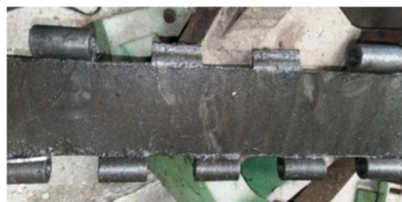
Fig. 11 Torn Hinge Loops
