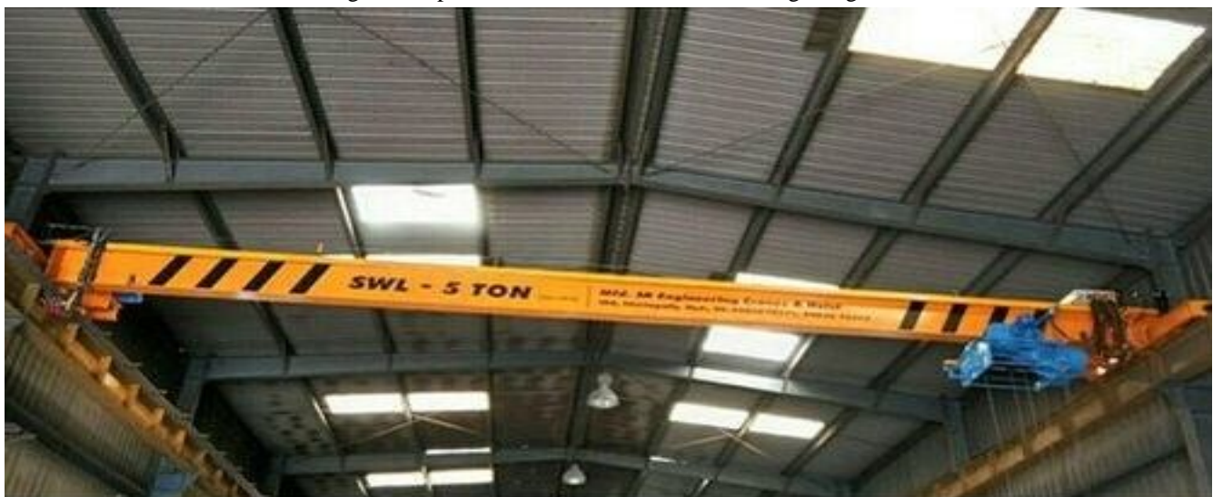
Fig. 3 5 Ton EOT Crane
