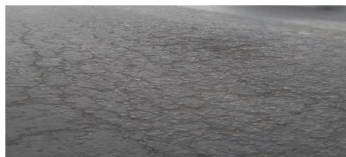
Fig: Fatigue Cracking
