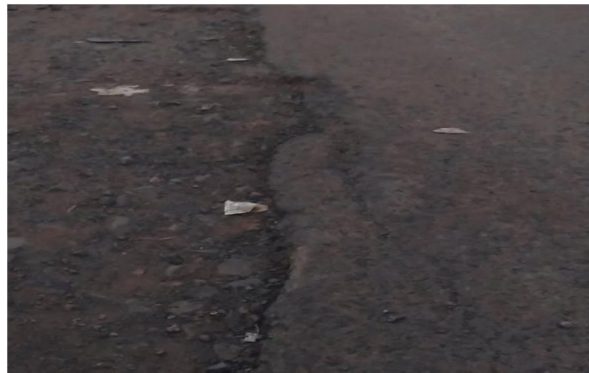
Fig:- Edge Cracking
