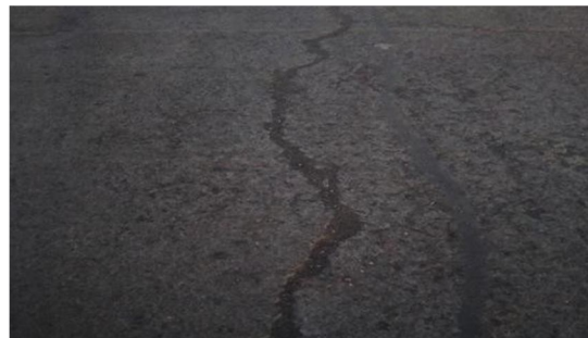
Fig: Longitudinal Cracking
