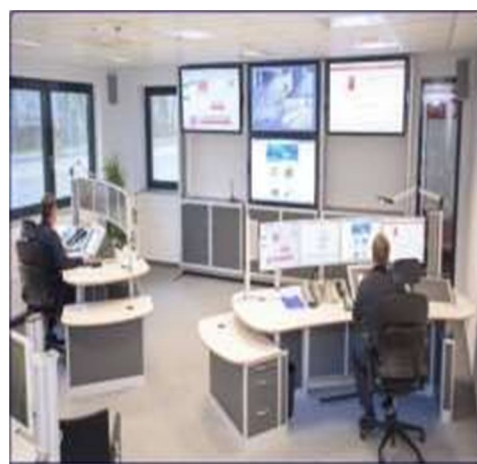
(d) Emergency Control Station
