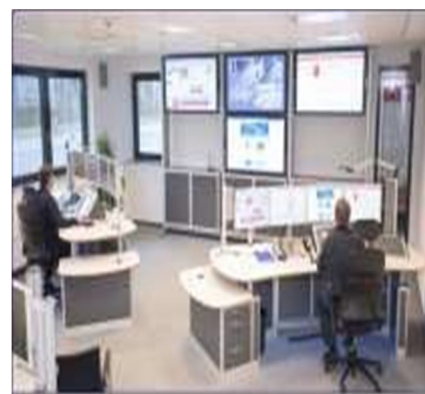
(d) Emergency Control Station
