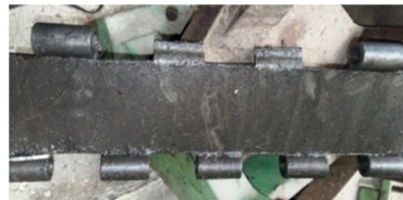
Fig. 11 Torn Hinge Loops
