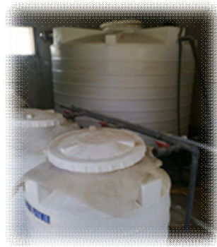
Fig: 2a. Fertigation Apparatus
