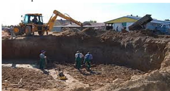
Fig: Excavation Hazard
