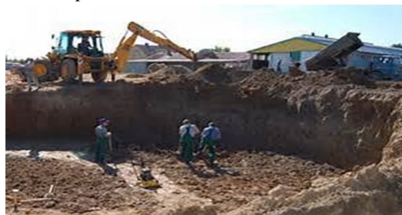
Fig: Excavation Hazard
